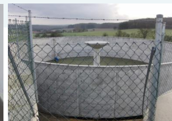
残渣保管タンク
