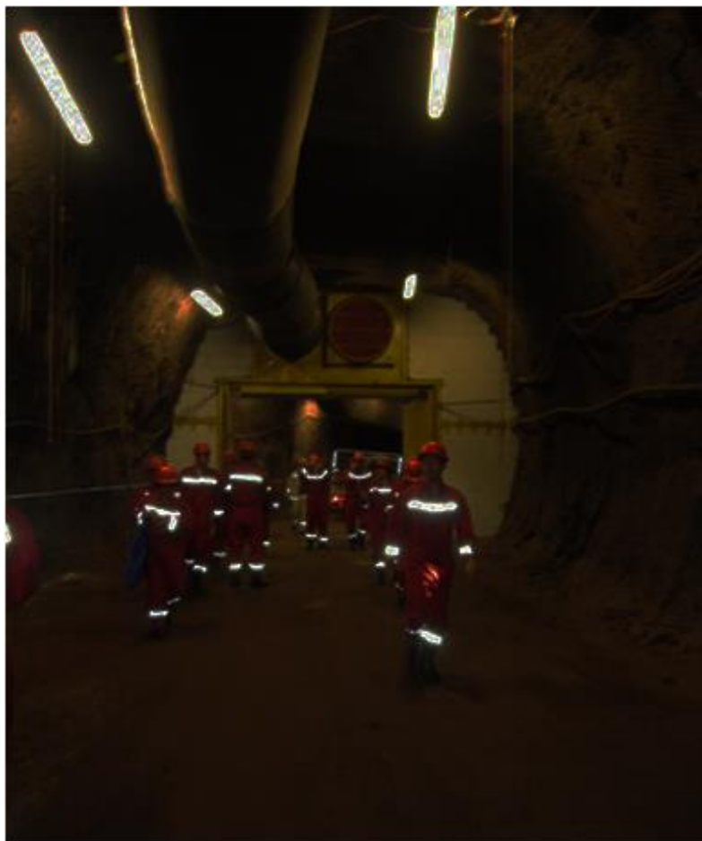
毎分14000m 3 の空気を地表から取り込み酸素を供給するダクトと坑道をブロック化し気流を制御する開閉ゲート。 気温26～30℃。
