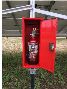
低圧発電所における 消火器設置
