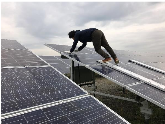
架台・モジュール取付強度の年次点検
