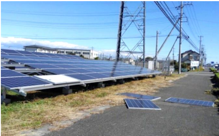
強風により太陽電池が構外へ飛散した他社事例
